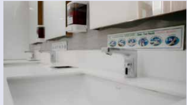
รณรงค์การใช้น้ำอย่างรู้คุณค่า ลดการสิ้นเปลือง และลดการสัมผัส โดยการใช้หัวก๊อกน้ำเซ็นเซอร์
